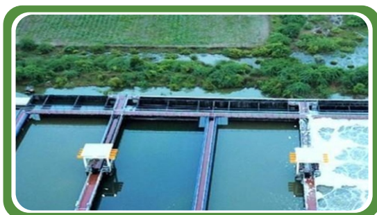
32.3 MLD STP, Surendra Nagar, Gujarat
